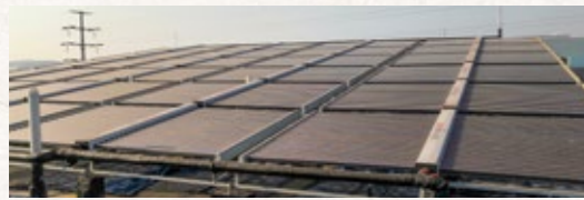
施工现场集热式太阳能热水器
