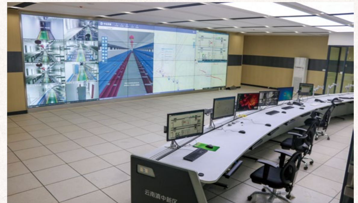
滇中新区智慧管廊监控大厅
