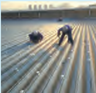
宝钢股份金太阳光伏发电示范工程
