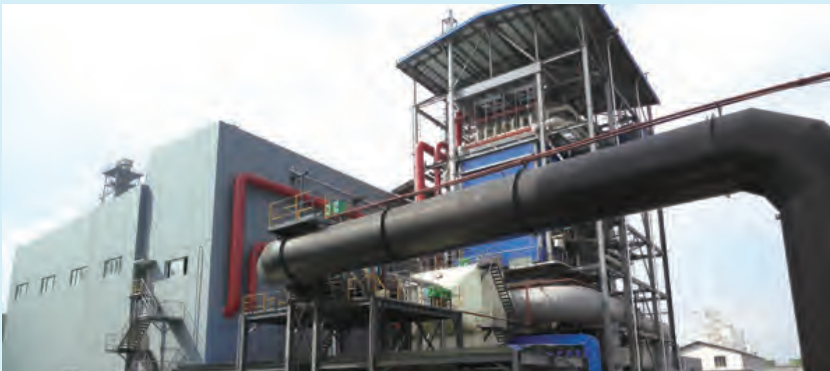
广西盛隆煤气发电现场全貌
