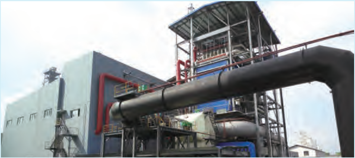
广西盛隆煤气发电现场全貌
