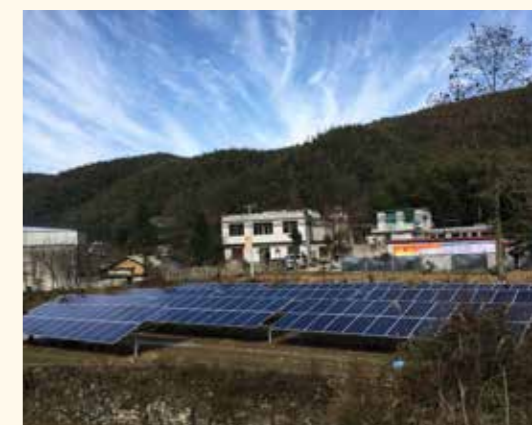
湖北省崇阳县天城镇松柏村光伏发电精准扶贫示范项目
