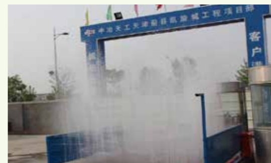
项目现场出入口设车辆冲洗设施，设专人管理，保证车辆出场清洁
